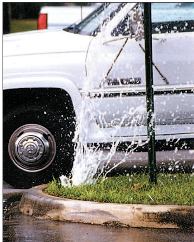
Figura 11. Pérdida de agua debido a la ruptura del dispersor.
